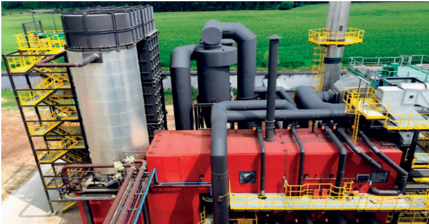
Centrale de combustion de biomasse avec chambre adiabatique horizontale - 12 MW - France
